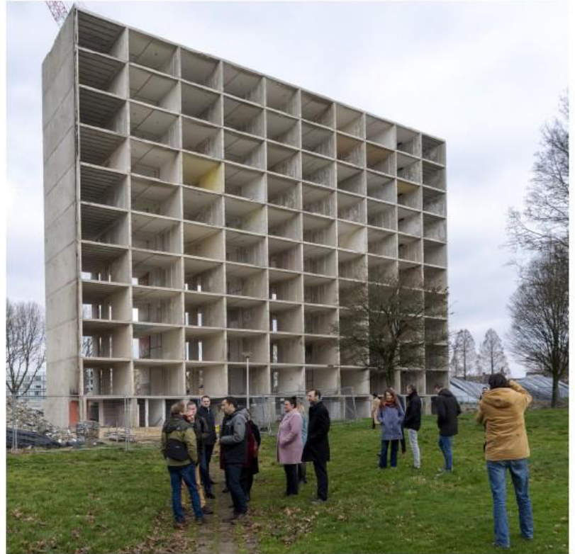
Politici en ambtenaren uit Brussel bij de gestrippte flat in Bleijerheide waarvan de materialen worden gebruikt in nieuwe huizen. FOTO PETER SCHOLS
